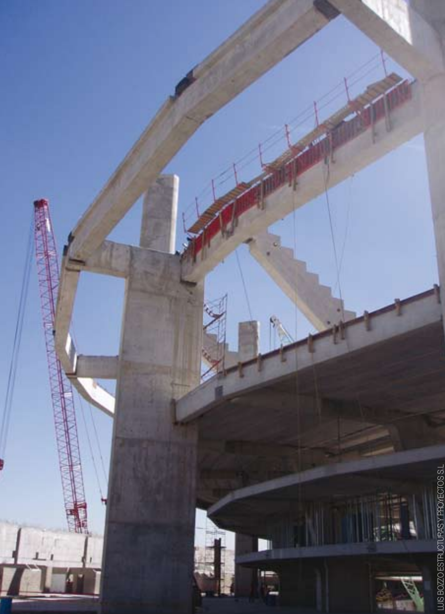
Vigas de transferencia que se apoyan en las macro-columnas y columnas interiores
